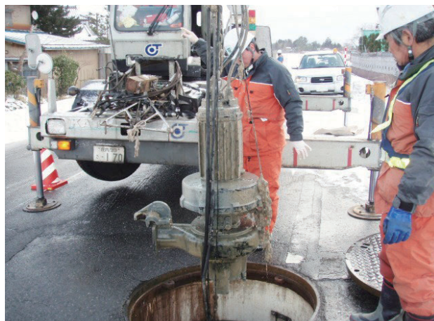
下水道施設維持管理
