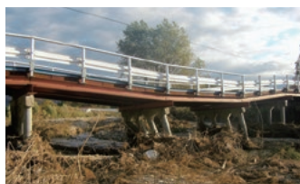
令和元年度台風19号災害（高畠町落合橋）
